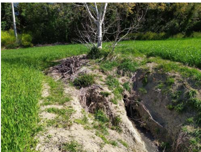
Foto 4: tombolo sottodimensionato, (tratto 23-24); l'acqua esce in pressione in occasione delle piogge, causando problemi di erosione delle sponde e del fondo del fosso recettore il progetto prevede che la pista ciclabile passi subito a monte ma non prevede attualmente alcun intervento.
